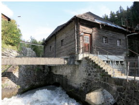
Die faszinierende, aber sanierungsbedürftige Anlage Pradapunt.
